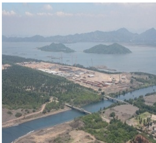
Figura 4. A la izquierda, la Terminal de Gas Natural Licuado Manzanillo en proceso de construcción (110ha).
