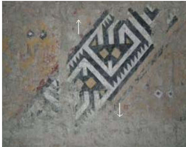
Figura 37. Muro este del Patio 2, Huaca Cao Viejo, donde se observa el movimiento vertical en sentidos opuestos expresado por las orientaciones de los lifes (Foto: CGM)
